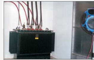
Ensayos en centros de transformación
