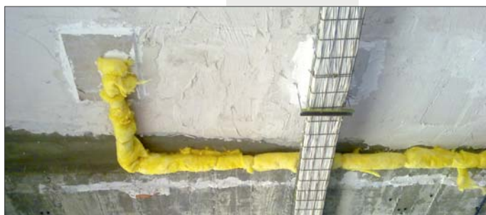
Aislamiento acústico de bajantes
