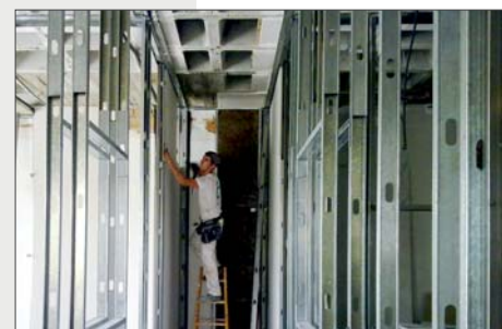
Estructura para aislamiento acústico de recintos
