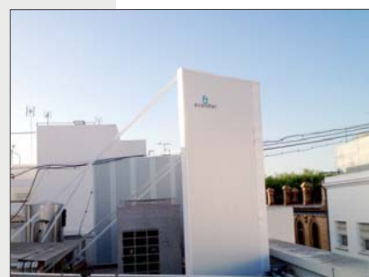
Pantalla acústica para compresores de A/A
