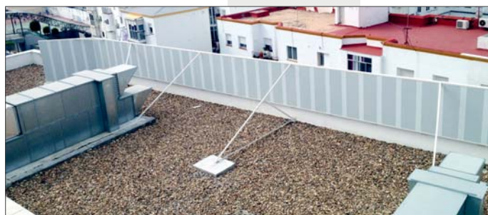
Pantalla acústica en cubierta para cajas de ventilación
