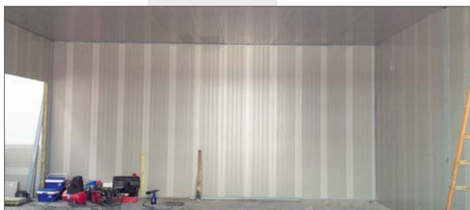
Interior cabina acústica, grandes dimensiones
