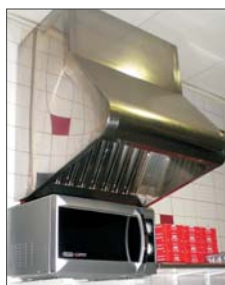
Extractor de cocina
