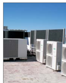
Compresores en cubierta
