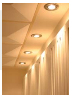
Detalle de iluminación
